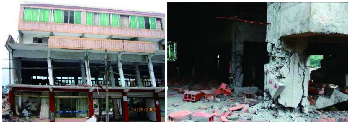
(a) 南坝镇强梁弱柱导柱顶产生塑性铰
